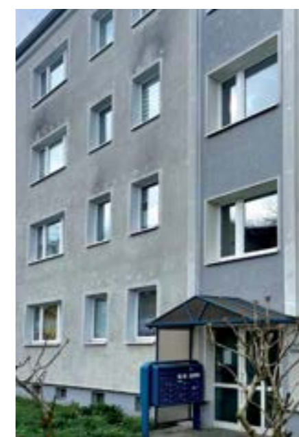
Fassade vor der Behandlung ...
