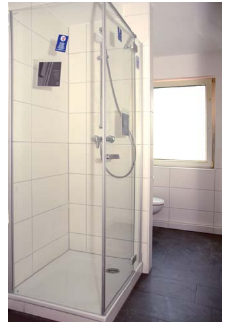
Die Bäder in den Wohnungen erstrahlen inzwischen in einer modernen Optik mit großformatigen, hellen Fliesen und neuer Badkeramik. Auch neue Duschkabinen wurden eingesetzt.
