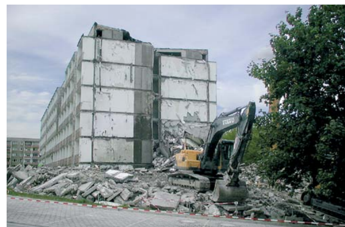
Zwischen 2006 und 2008 investierte die RUWO jährlich zwischen 5 und 7 Millionen Euro in Rückbau und Aufwertung. Beispielsweise wurde 2004 der einstige RUWO-Firmensitz Erich-Correns-Ring 1 zurückgebaut.
